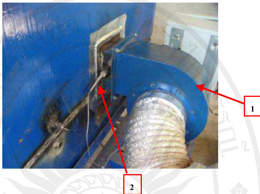
ภาพประกอบ 35 1 การติดตั้ง โบเวอร์ และ 2 หัววัดอุณหภูมิวัดลมร้อน
