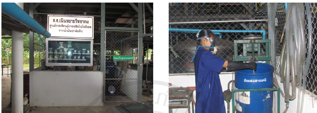
ภาพประกอบ 29 พื้นที่จัดเก็บและถังผสมสารเคมี ป้องกันอันตรายต่อนักปฏิบัติการเคมี
