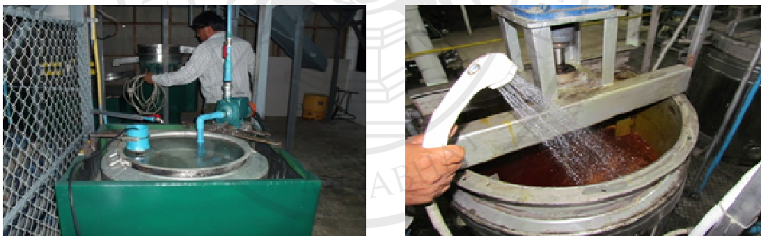
ภาพประกอบ 28 ระบบทำความร้อนและปั้มน้ำในกระบวนการล้างยางเหนียว และล้างไบโอดีเซล
