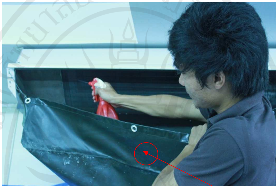
ภาพประกอบ 17 แสดงการติดตั้งผ้าใบรับน้ำและการฉีดน้ำยาล้างแผงคอยล์เย็น ผ้าใบรับน้ำ
