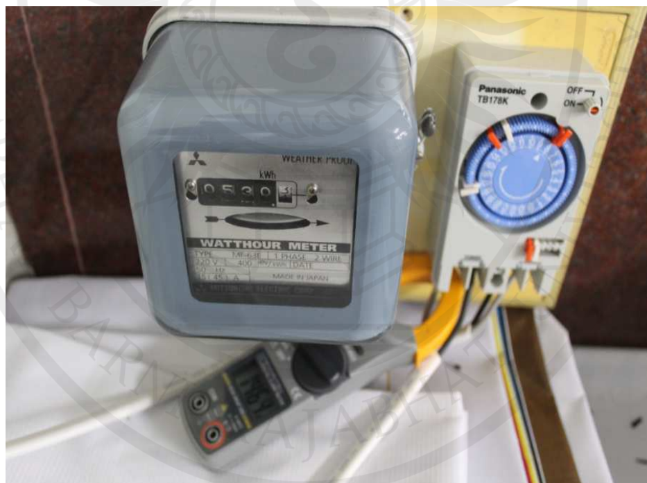
ภาพประกอบ 13 การใช้เครื่องมือวัดกระแสไฟฟ้าชนิดคล่องสาย ตรวจสอบวัดค่ากระแสไฟฟ้าในระบบปรับอากาศ
